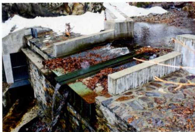
Pietrisco e fogliame (freccia) intasano le canaline by pass apposte per il DMV su griglia a captazione totale.
